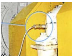
Trasmettitore vibrazionale 4-20 mA installato su supporto cuscinetto
